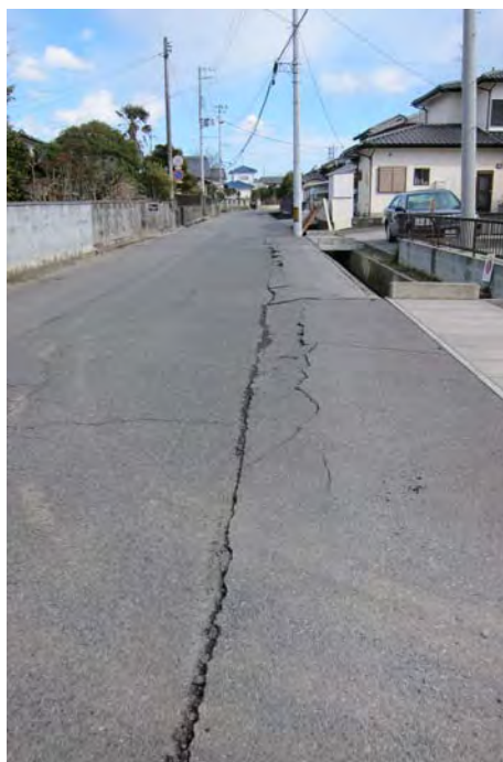
写真6．道路の亀裂（いわき市渡辺町） （3月27日筆者撮影）
