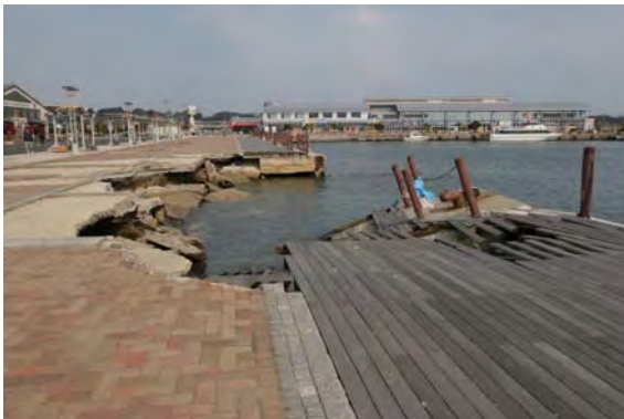
写真4. アクアマリンパーク歩道の被害 (3月29日筆者撮影)
