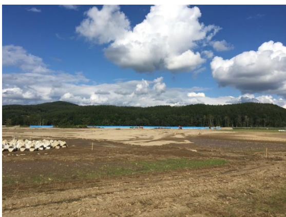
写真1 堤防の決壊地点
