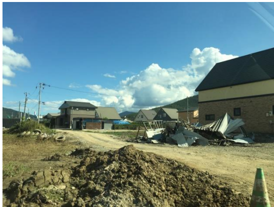
写真7 倒壊した倉庫
